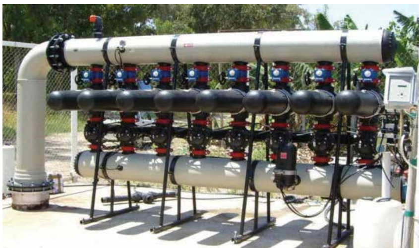
Fig. 29. Stație automate de filtrare
